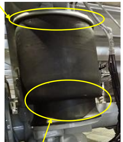
エア・スプリングとピストン間 第 1 図. エア・スプリングの点検
