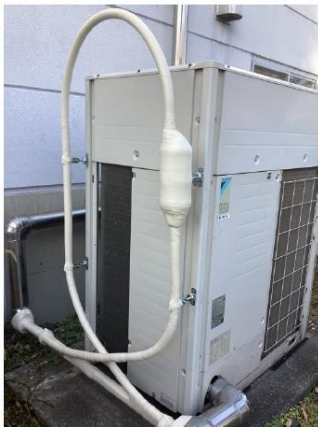
設置室外機:RXYP450DA 設置機種:αESG280
