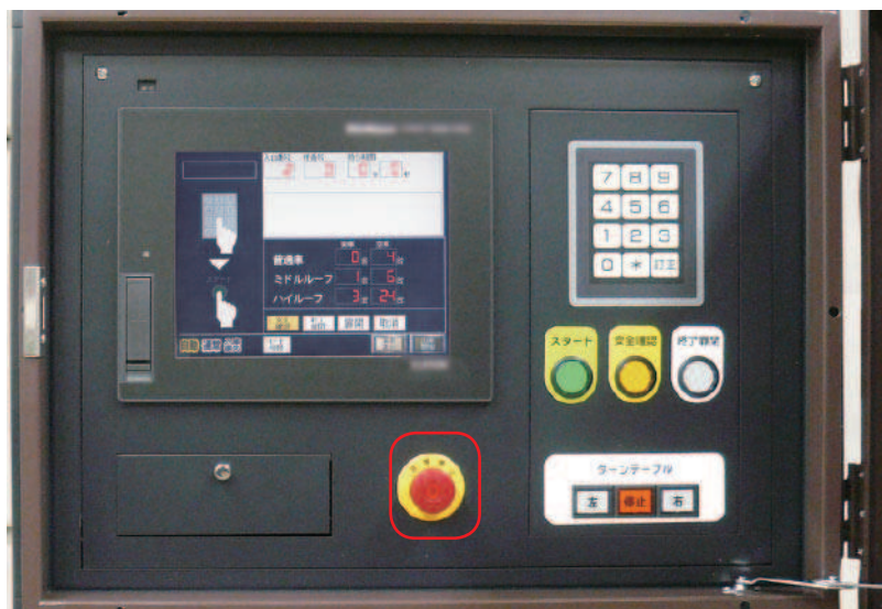
緊急停止ボタンの設置例
