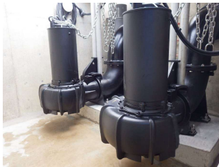
道路排水設備用大型水中ポンプ (ポンプ口径400mm × 出力22kW)
