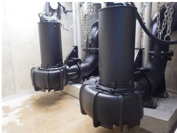
道路排水設備用大型水中ポンプ (ポンプ口径400mm×出力22kW)
